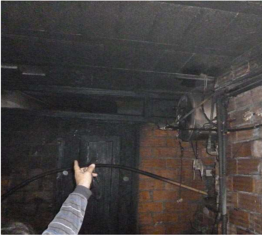
el fuego se inició en la caldera
